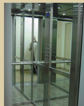
Moderno y funcional. Vista del nuevo ascensor.
